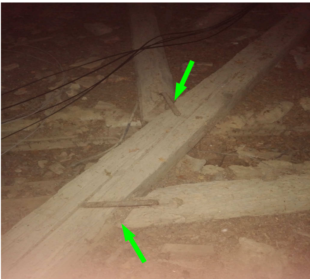
Zdegradované a uvoľnené tesárske spoje väzných trámov, ležiace na stropnej konštrukcii objektu
