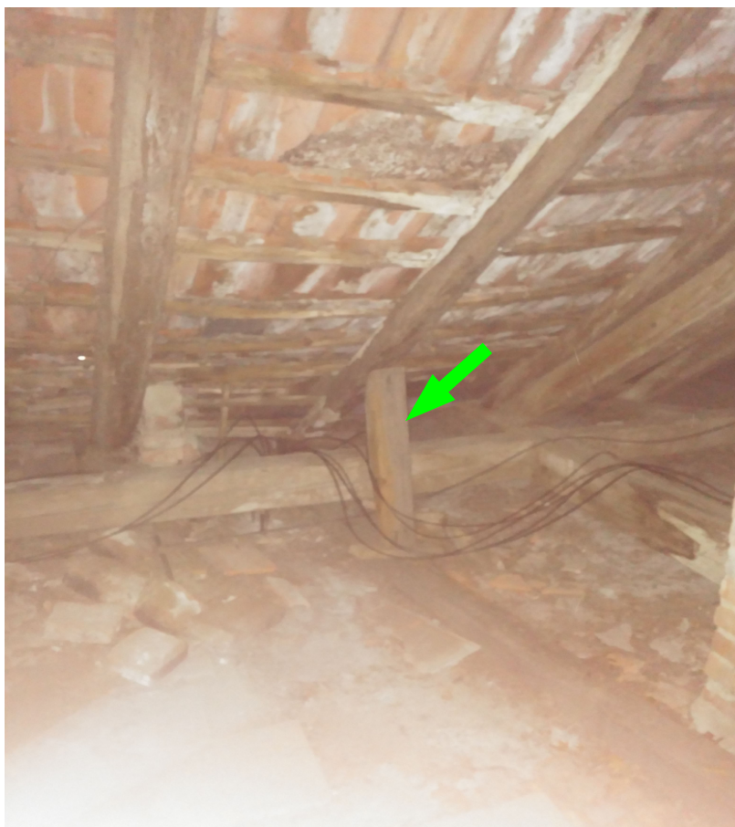
Viditeľný priehyb krokvy a laťovania strešného plášťa, sanovaný dreveným stĺpikom
