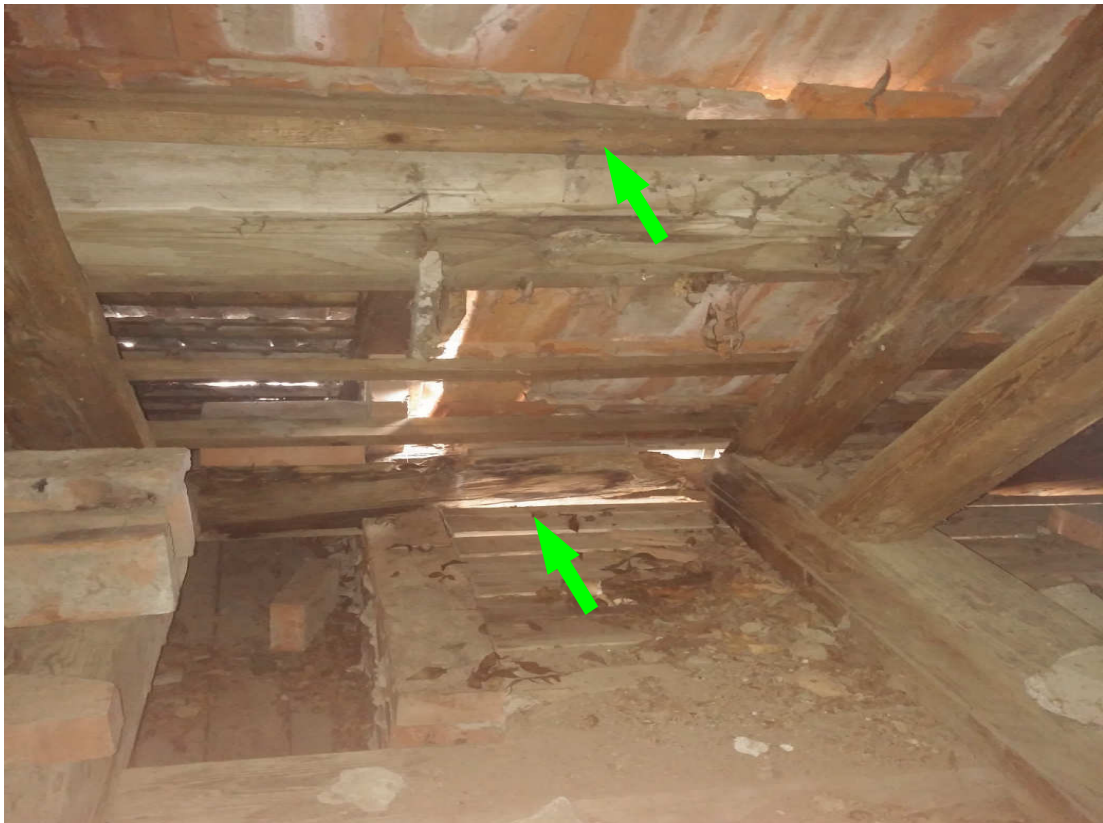
Zdegradované tesárske spoje krovu, laťovanie s viditeľným priehybom
