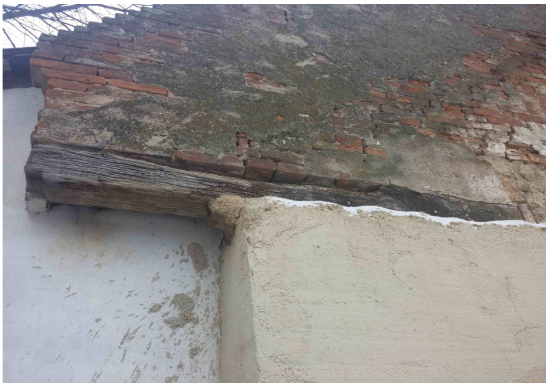
Zdegradovaný drevený trám pod štítovou stenou
