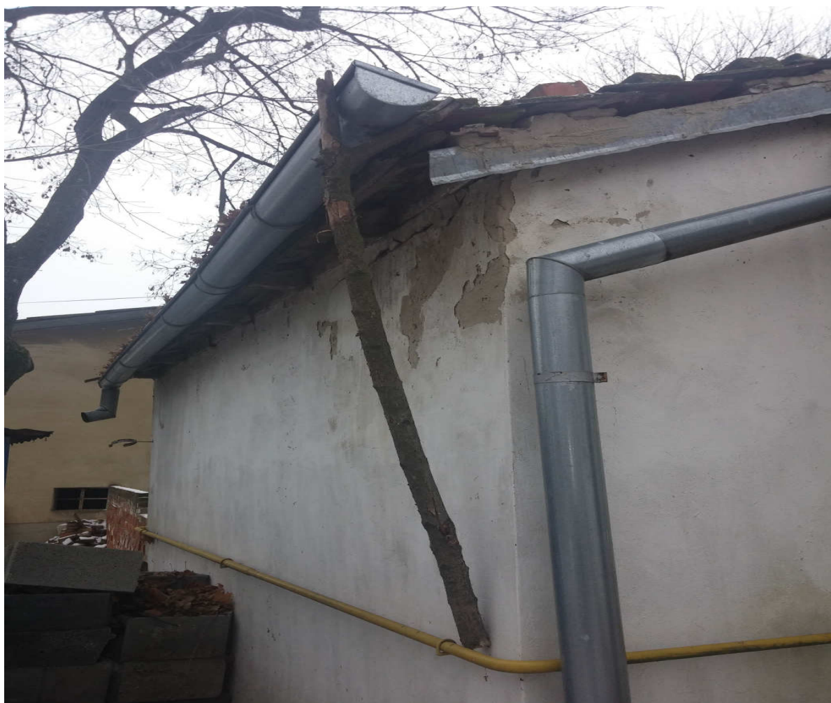
O technickom stave krovu svedčí aj potreba podchytenia žlabu, ktorý by mal byť prichytený ku krokvám.
