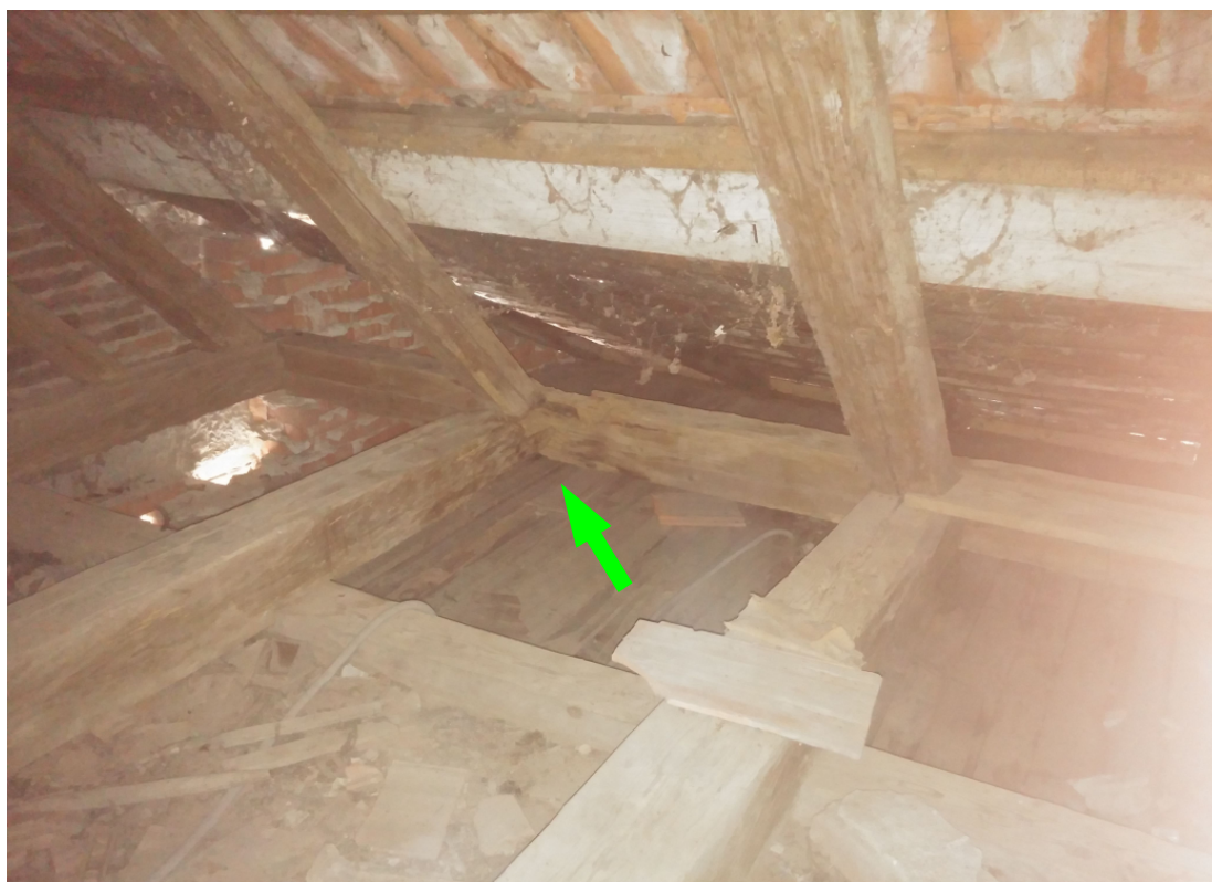
Typický hnilobou zdegradovaný tesársky spoj krovu
