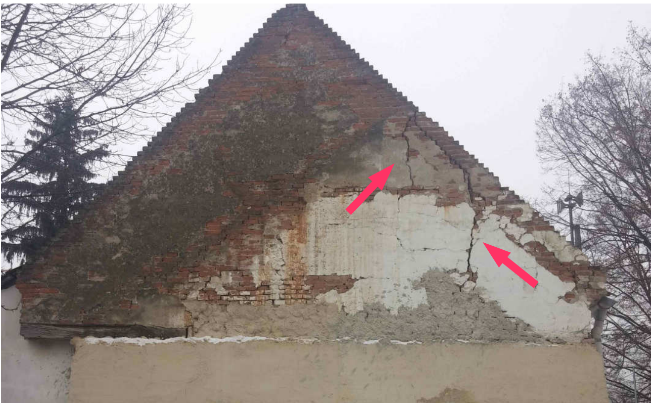
Štítová stena s trhlinami v murive
